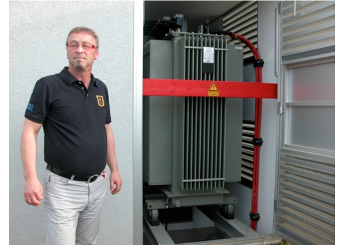
Werner Schmelmer vorm Trafohaus
