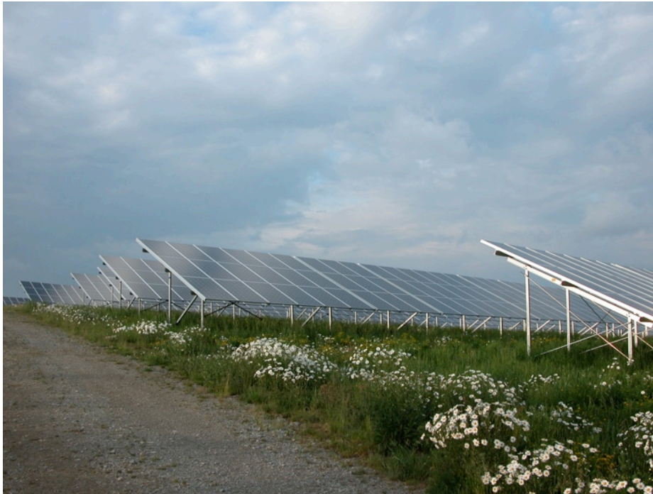
Die Anlage hat 46095 Module auf ca. 28 Hektar Fläche und eine Jahresproduktion von 10,4 Gwatt.
