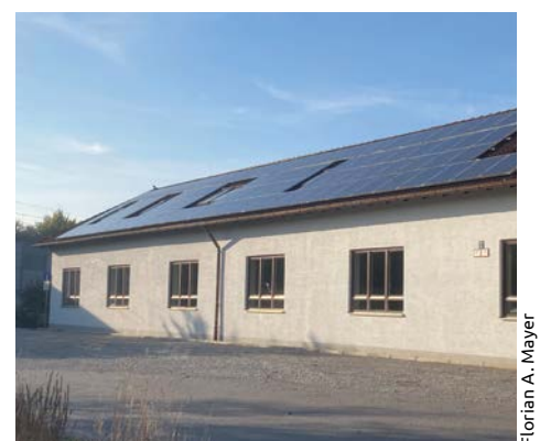
Photovoltaik-Anlage des Bauhofs
