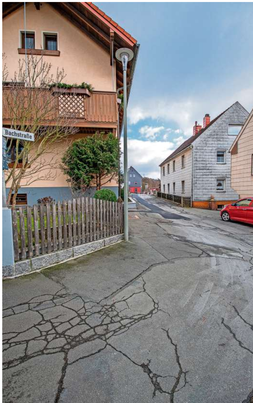
Wie hier in der Bachstraße sieht es in einigen Ecken Döhlaus aus. Die kaputten Straßen sollen nach und nach repariert werden, sagen die drei Bürgermeisterkandidaten.
