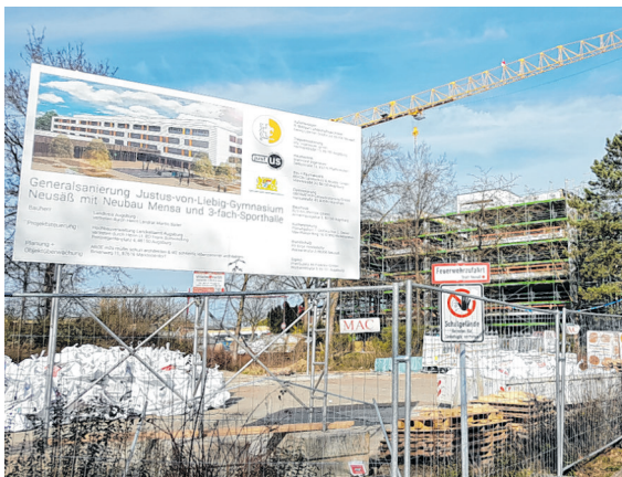
Die CSU-Kreistagsfraktion hat sich für die Generalsanierung des Justus-von-Liebig-Gymnasiums in Neusäß eingesetzt. Neben dieser wird es einen Neubau für die Mensa und eine Dreifach-Sporthalle geben.
