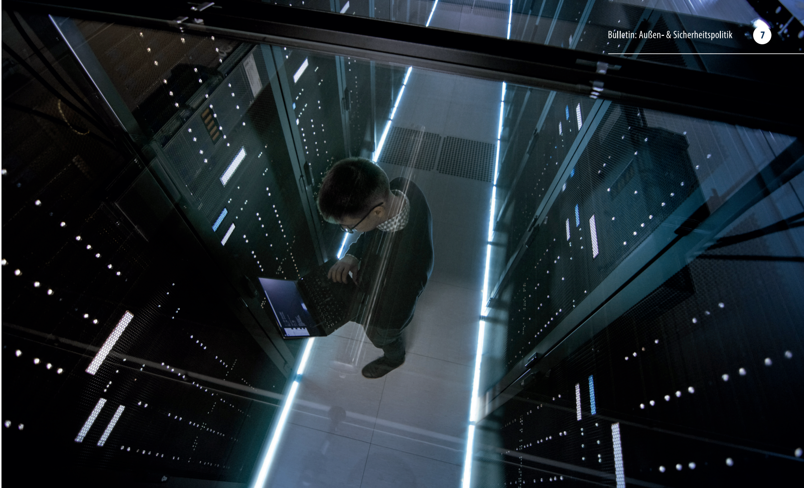
IT-Engineer in einem Rechenzentrum
